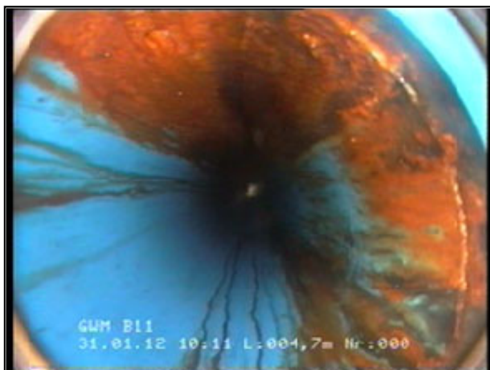
Abbildung 2: Messbeispiel, Undichte Rohrverbindung mit Feststoffeintrag
